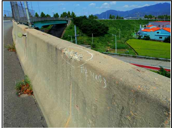
콘크리트 파손 (S1경간)
