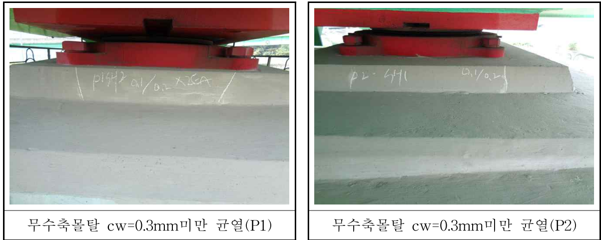
【그림 3.19】 교량받침 손상 현황
