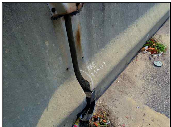
콘크리트 파손 (S3경간)
