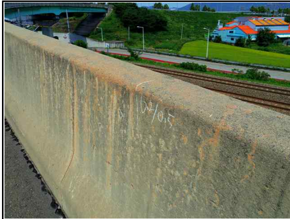
콘크리트 균열 (S1경간)
