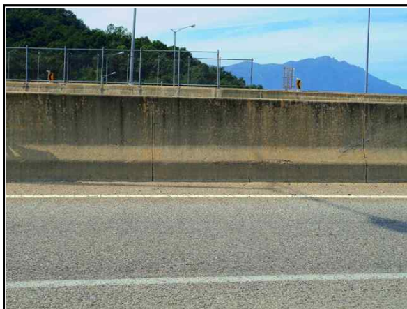
콘크리트 굽힘 (S2경간)
