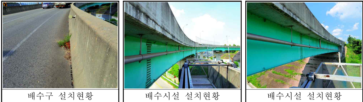
【그림 3.23】 배수시설 현황
